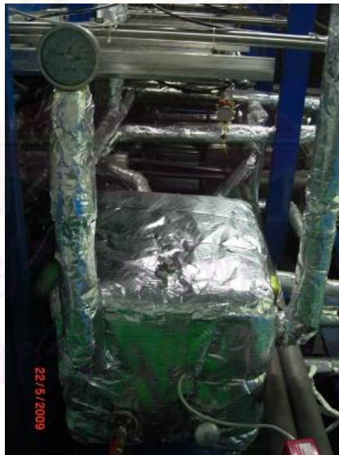
รูปที่ 32 ถังต้มน้ำมันร้อน
