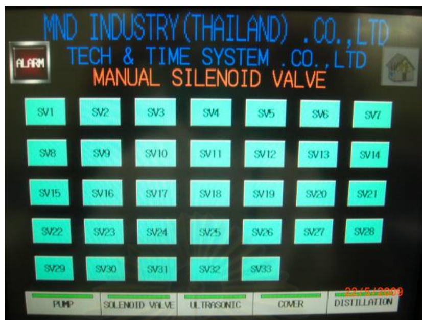
รูปที่ 16 หน้าจอควบคุมโซลินอยด์วาล์วด้วยตนเอง
