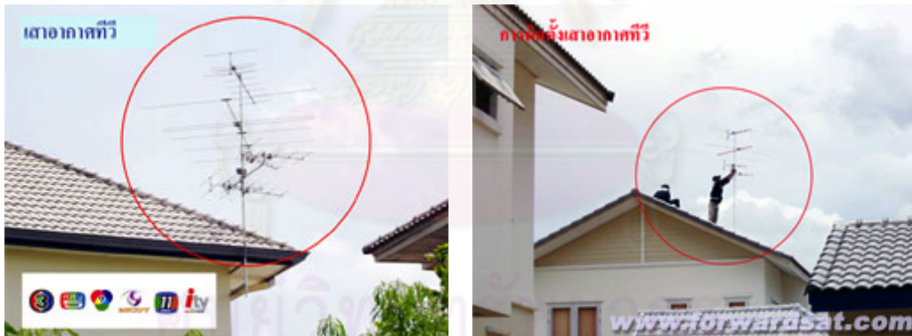
ภาพ ตัวอย่างของเสาอากาศโทรทัศน์ และติดตั้งเสาอากาศโทรทัศน์
