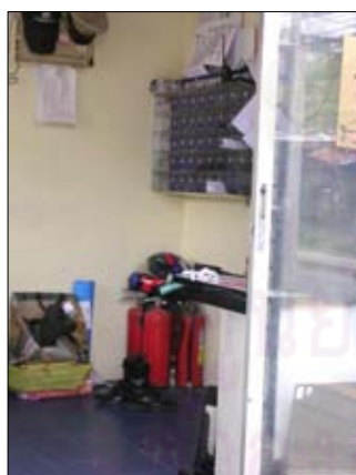
- ถังดับเพลิงแบบมือถือที่ป้อมเจ้าหน้าที่รักษาความปลอดภัย
