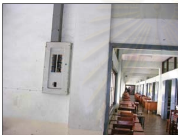
- ตู้ควบคุมไฟฟ้าติดตั้งประจำแต่ละชั้นของอาคาร
