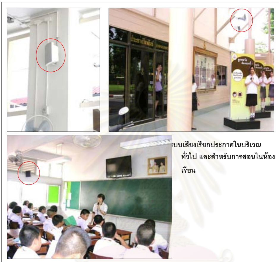
ภาพที่ 3.3.9 ระบบเสียงเรียกประกาศ / PA system
