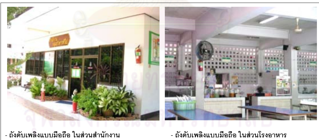
ภาพที่ 3.4.6 ถังดับเพลิงแบบมือถือ
