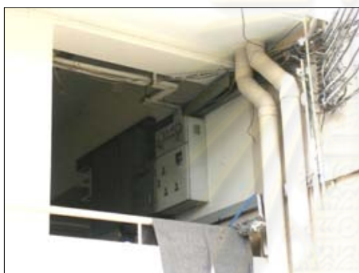
- ตู้ควบคุมไฟฟ้าประจำอาคาร
