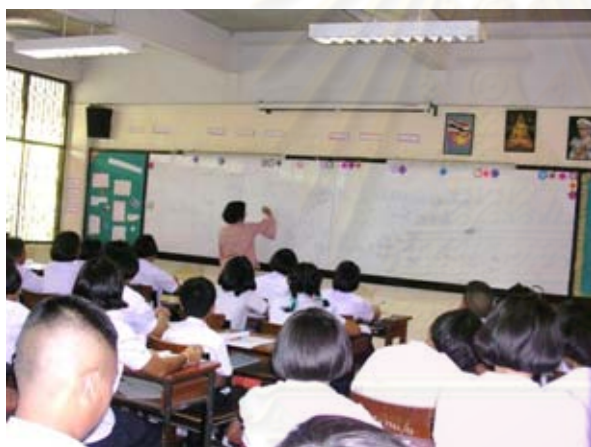
- ระบบแสงสว่างในส่วนของห้องเรียน
