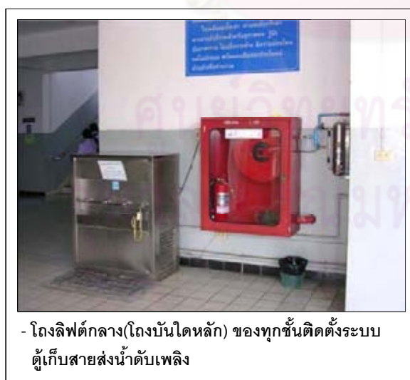
ภาพที่ 3.1.7 ตู้เก็บสายส่งน้ำดับเพลิง
