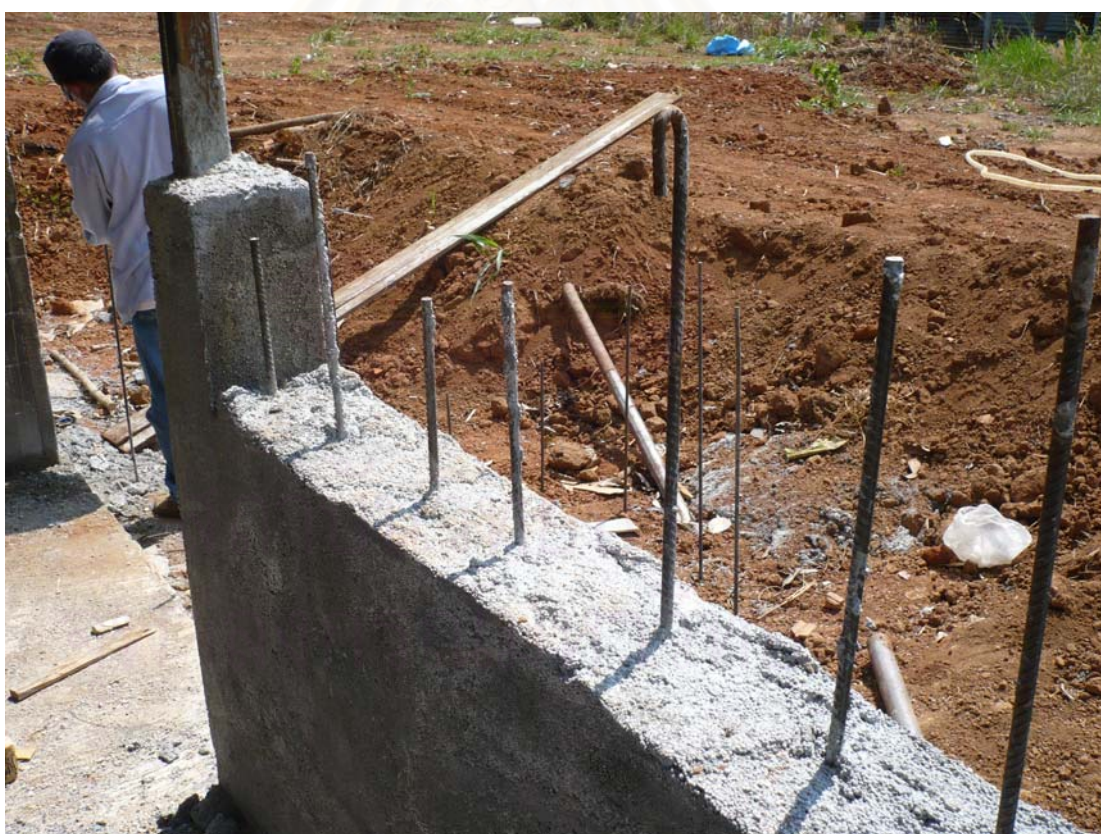
รูปที่ 5.5 แสดงโครงสร้างของอาคารบ้านพักอาศัยกรณีศึกษา (สถานที่ก่อสร้างในโครงการ อีโค-สเฟียร์ เขาใหญ่ จังหวัดนครราชสีมา วันที่ 2 พฤษภาคม 2551)
