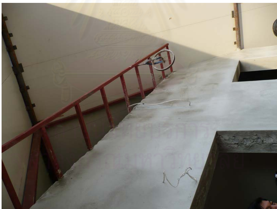
รูปที่ 5.2 แสดงบรรยากาศการก่อสร้างตัวอย่างภายในอาคารบ้านพักอาศัย 2 ชั้น ขนาด 100 ตารางเมตร ที่มีเปลือกอาคารเป็นวัสดุโพลีคอนกรีตหนา 0.20 เมตร (สถานที่ก่อสร้างในโครงการ อีโค-สเฟียร์ เขาใหญ่ จังหวัด นครราชสีมา วันที่ 4 พฤษภาคม 2551)
