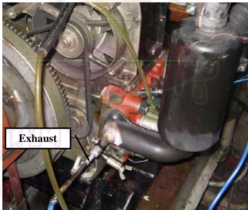
รูปที่ 4-12 แสดงการติดตั้งเทอร์โมคัปเปิลที่ท่อไอเสีย
