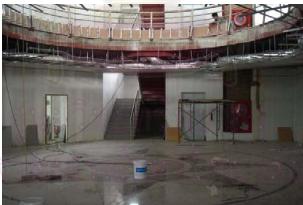
รูปที่ 1.9 โครงสร้างอาคาร งานสถาปัตยกรรม และงานระบบประกอบอาคารไม่สอดคล้องกัน
