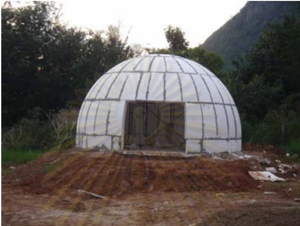
รูปที่ 4.22 การติดตั้งเปลือกอาคารบ้านทรงโดม
