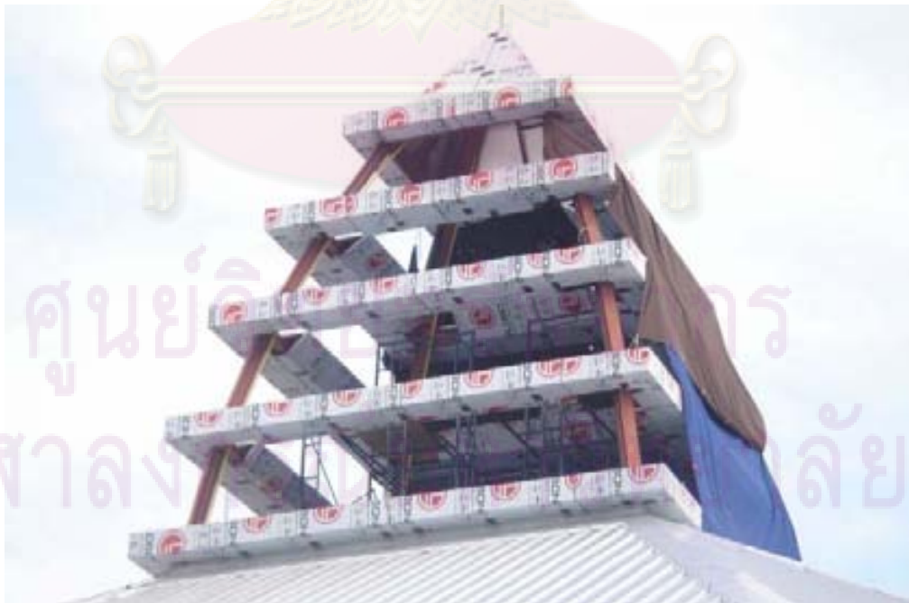
รูปที่ 1.7 การก่อสร้างช่องแสงยอดหลังคา ต้องป้องกันฝนสาดเข้าภายในอาคาร
