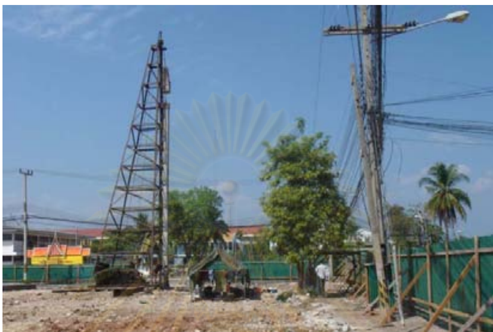
รูปที่ 1.2 การตอกเสาเข็ม มีแนวสายไฟฟ้าแรงสูงโดยรอบ
