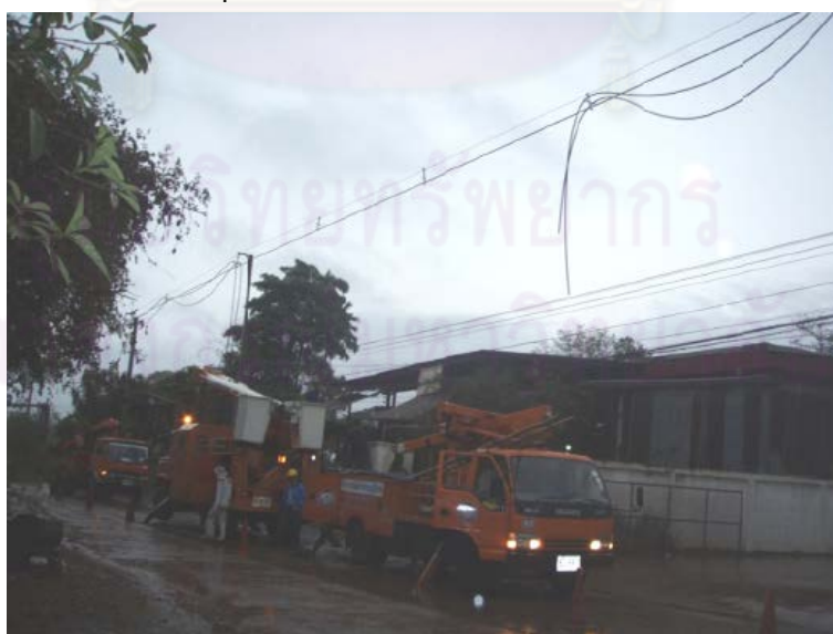
ภาพที่ 1.3 เหตุการณ์สายจ่ายไฟฟ้าขาด 2 เฟสจากสถานที่จริง
