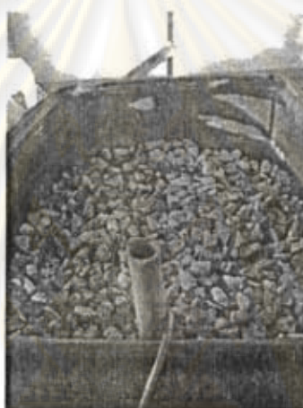
ง. สายยางกระจายน้ำเสีย
