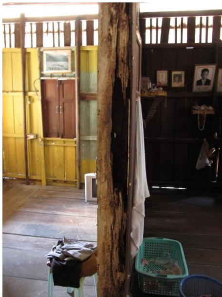
ภาพที่ 4.11 ไม้โครงสร้างเสาที่โดนปลวกกิน
