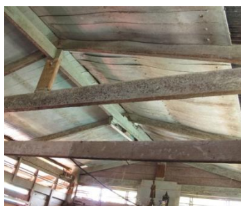
ภาพที่ 4.10 ไม้โครงสร้างหลังคาที่เก่า ผุ
