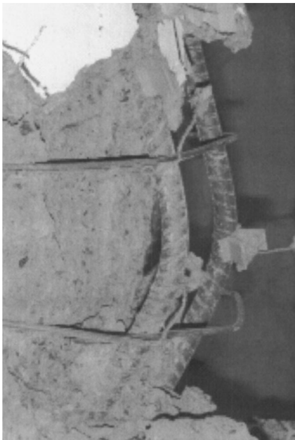
ภาพที่ 1.1 แสดงการเกิดการโก่งเดาะของเหล็กเสริมยื่นที่เกิดขึ้นในเสา เมื่อคอนกรีตหุ้มเกิดการแตกร้าว (Berry และ Eberhard, 2005)
