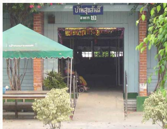
รูปที่ 5.17 แสดงบันไดและทางลาดของอาคารสุขสันต์
