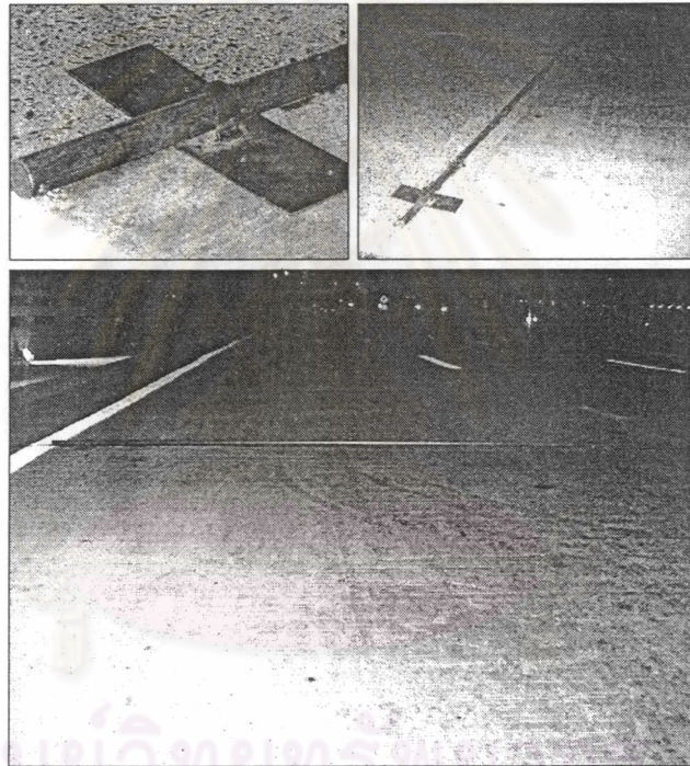
รูปที่ 6.27 อุปกรณ์ที่ทำให้เกิดความขรุขระบนสะพาน
