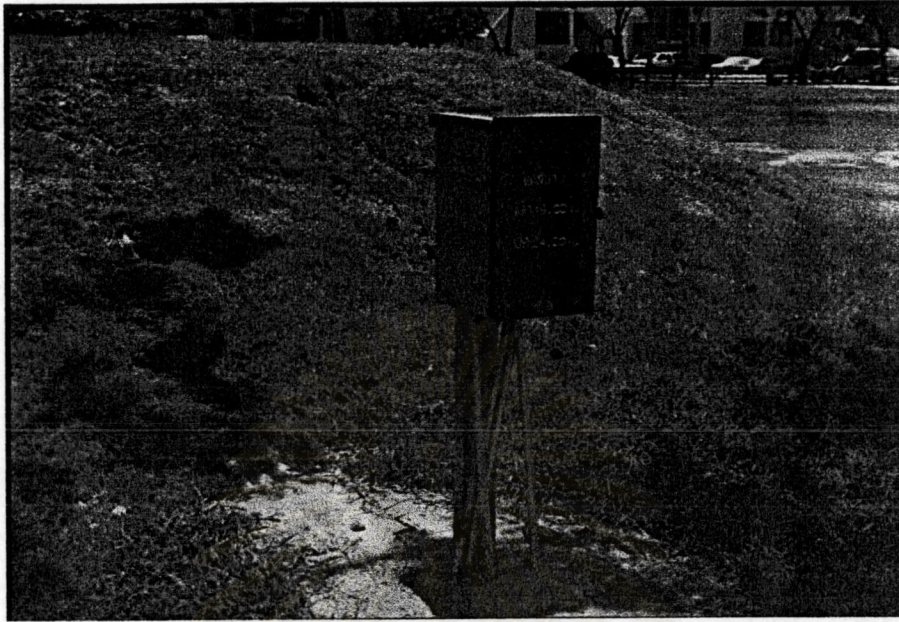
ภาพที่ 3.20 แสดงตู้ควบคุมไฟสนามกลางชุมชน
