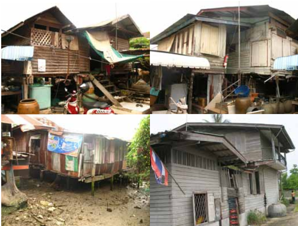
ภาพที่ 5.11 แสดงสภาพที่อยู่อาศัยที่ทรุดโทรมเจ้าของไม่สามารถซ่อมแซมได้
