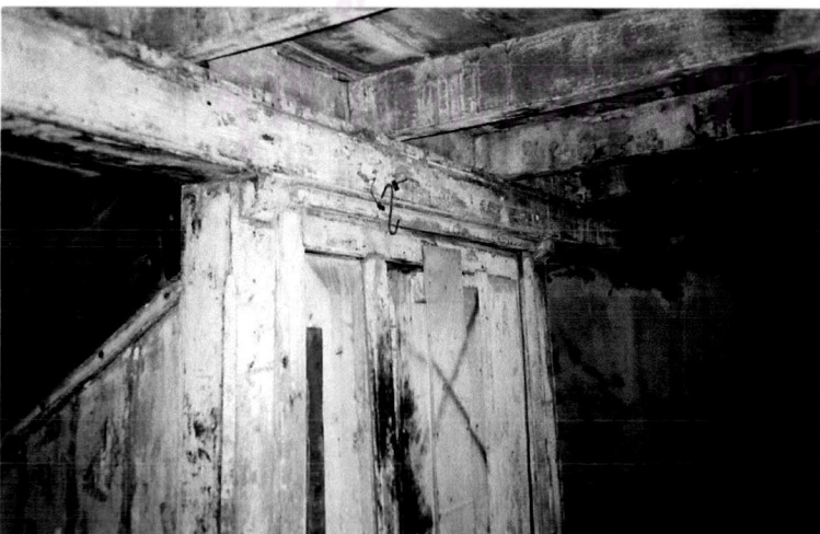
รูปที่ 4-41 ภาพแสดงการเสื่อมสภาพของโครงสร้างบ้านไคหลัก
