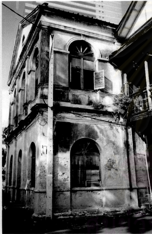
รูปที่ 4-53 ภาพแสดงการเสื่อมสภาพของผนังภายนอกด้านหน้าอาคาร
