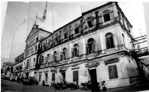
รูปที่ 4-35 ภาพแสดงสภาพความเสียหายจากด้านหน้า อาคารประธาณ
