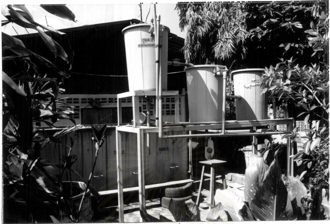
ภาพที่ ค 1.1 ถังพักน้ำเสีย
