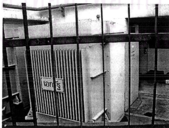
รูปที่ 4.25 หม้อแปลง station service ขนาด 112.5 kVA ของสถานีไฟฟ้าย่อย ซึ่งรับไฟจ่ายสายป้อน BZ14 โดยต่ออยู่ที่ต้นทางของสายเคเบิลใต้ดิน
