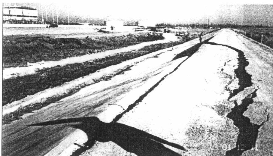
รูปที่ 4.12 แสดงการพังทลายของบ่อเก็บน้ำ ณ ตำแหน่ง STA +650
