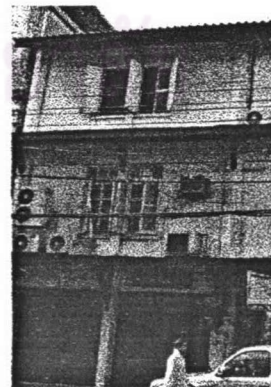
การติดตั้งเครื่องปรับอากาศซึ่งขาดการออกแบบ
