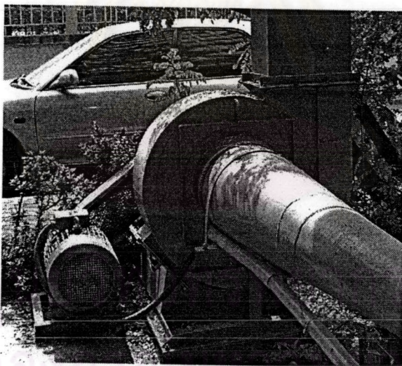
รูปที่ 5.5 ภาพถ่ายของเครื่องเป่าลม
