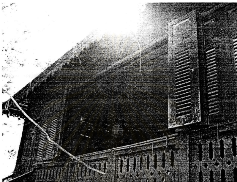
รูปที่.๓.๒.๑๘ แสดงช่องเปิดบริเวณมุขด้านหน้าของบ้าน โดยใช้หน้าต่างบานเฟี้ยม
