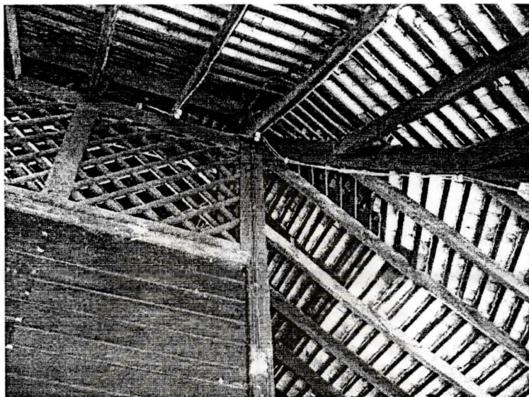
รูปที่ ๓.๓.๑๖ แสดงช่องลมภายในตัวอาคารและโครงสร้างหลังคา
