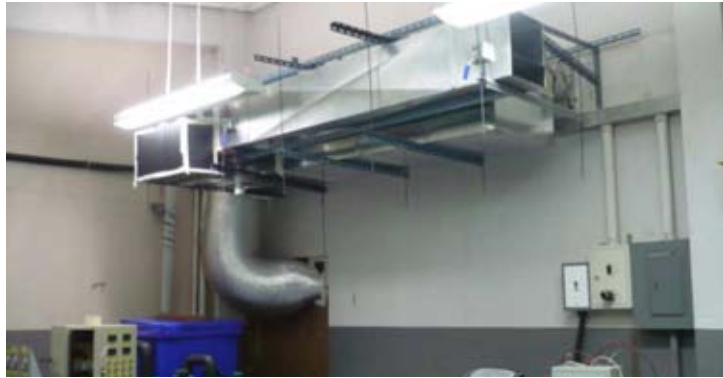
ภาพที่ 5.1 ท่อลมที่ได้ทำการติดตั้งเพื่อควบคุมปริมาณลมเข้า ออกเครื่องเป่าลมเย็น
