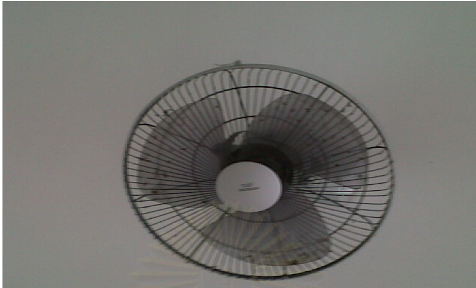
รูปภาพที่ 4.15 สภาพพัดลมโรงอาหารรวมอาคารจุลจักรพงษ์ที่มีฝุ่นเกาะอย่างเห็นได้ชัด
