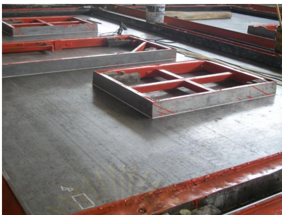
รูปที่ 3.3 ลักษณะของแบบหน้าต่าง ประตู (Block Out หรือ B/O)
