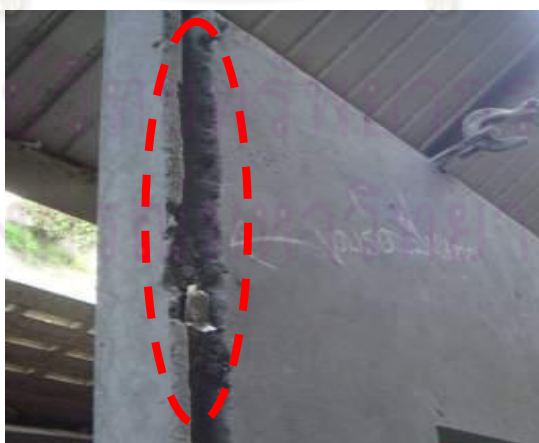
รูปที่ 3.27 ลักษณะ Key Joint บิ่นแตก
