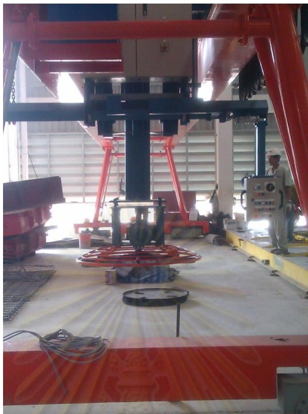
รูปที่ 6.15 การติดตั้งเครื่องขัดแบบครน ทำงานร่วมกับเครื่องขัดแบบ handling
