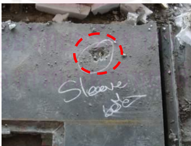
รูปที่ 3.29 ลักษณะท่อ Sleeve ไม่ตรงตำแหน่ง
