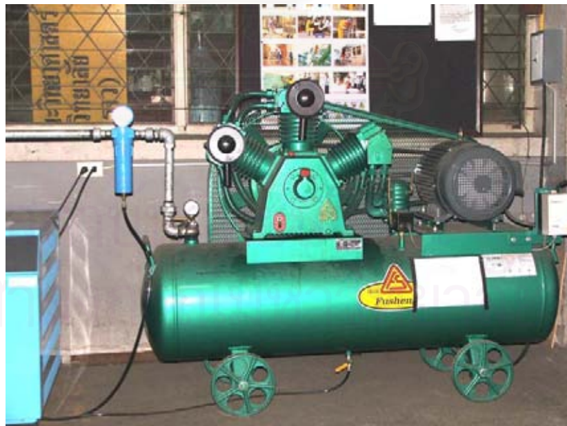
รูปที่ 3.5 เครื่องอัดอากาศเครื่องที่ 2 (Air Compressor)
