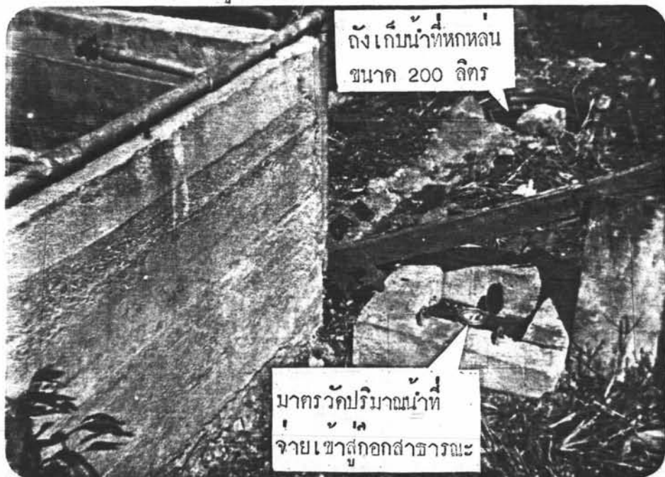
รูปที่ 6.4 แสดงการระบายน้ำส่วนที่หกหล่นจากการใช้น้ำที่กอกสาธารณะแล้วไหลลงสู่ถัง 200 ลิตร
