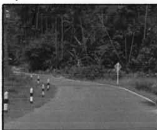
สภาพถนนบริเวณบ้านแจ๊ะหดี
