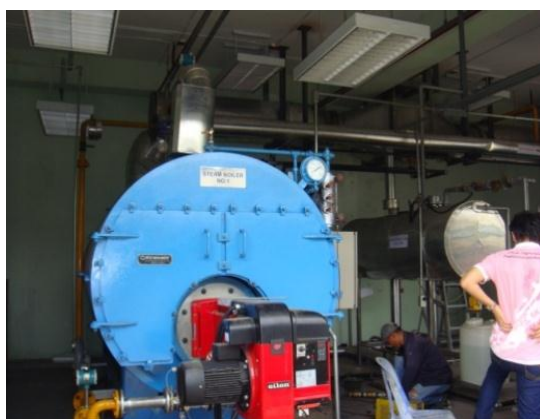
ภาพที่ 5.2 หม้อไอน้ำหลังการติดตั้งอีโคโนไมเซอร์
