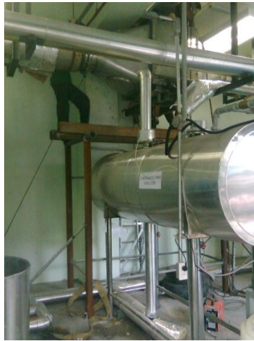
ภาพที่ 4.10 แสดงการติดตั้งอีโคโนไมเซอร์
