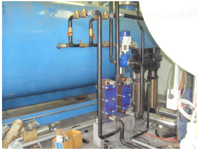
ภาพที่ 4.12 ระบบท่อและอุปกรณ์อุ่นน้ำป้อน (Plate Heat Exchanger)
