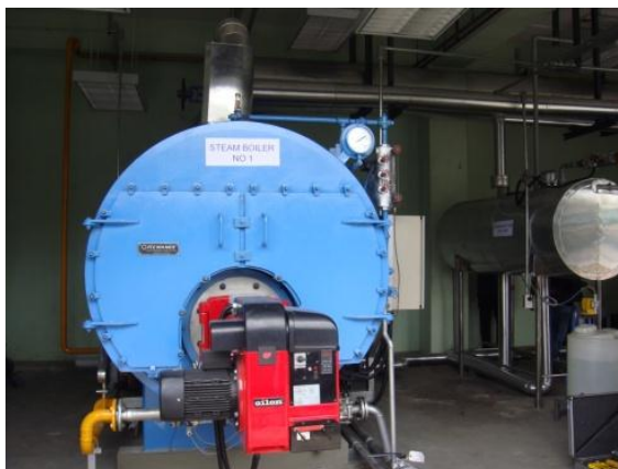
ภาพที่ 5.1 หม้อไอน้ำก่อนการติดตั้งอีโคโนไมเซอร์
