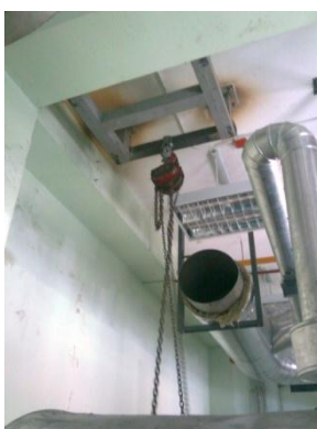
ภาพที่ 4.8 ตำแหน่งการติดตั้งอีโคโนไมเซอร์
