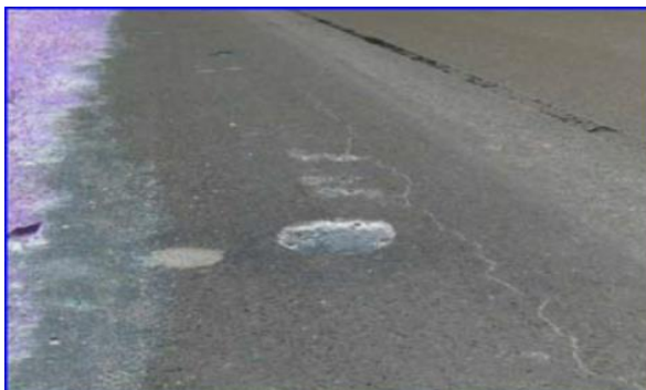
ภาพที่ 2.4 การเกิดหลุมบ่อบนผิวทาง
