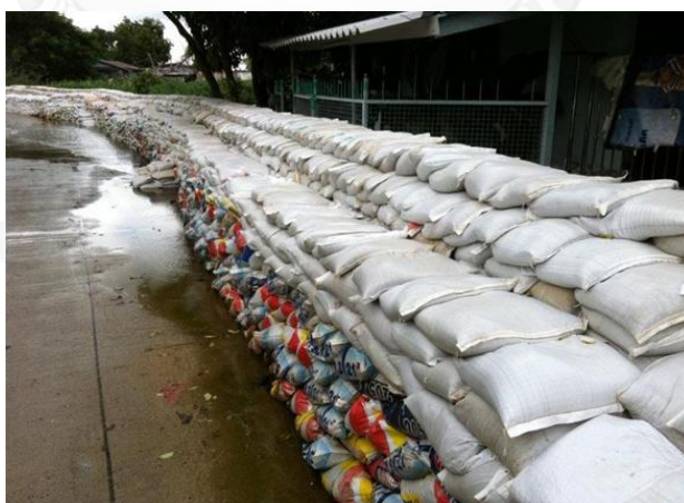
แผนภาพที่ 2.9 รูปแบบคันป้องกันน้ำท่วมแบบฉุกเฉิน
