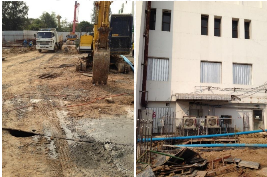
ภาพที่ 27 บริเวณบ่อบำบัดน้ำเสียเดิมของโรงพยาบาลกรุงเทพราชสีมา
