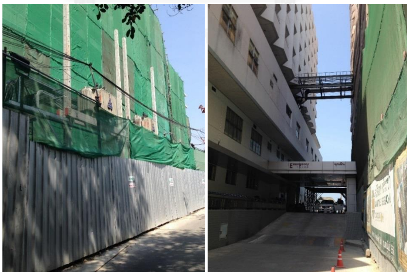
ภาพที่ 19 การกันพื้นที่ก่อสร้างโรงพยาบาลสมิติเวช ศรีราชา
