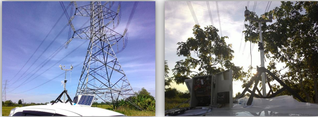
รูปที่ 5-3 ชุดตรวจวัดวางบนหลังรถแทนการติดตั้งบนเสาส่ง
