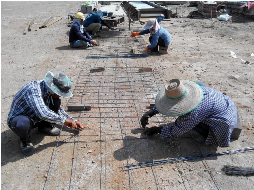
ภาพที่ 4.15 ขั้นตอนการผูกเหล็กเสริมคอนกรีต
