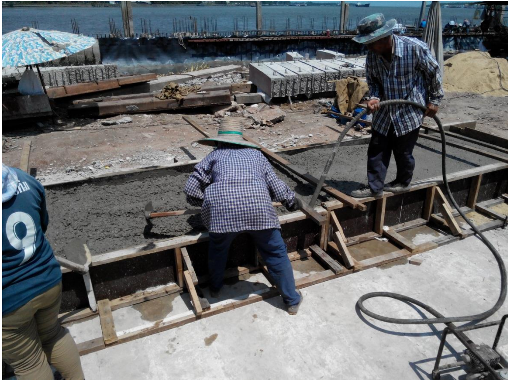
ภาพที่ 4.20 การปั๊มคอนกรีตเพื่อให้คอนกรีตสามารถถูกอัดแน่นในแบบหล่อได้อย่างเต็มที่
