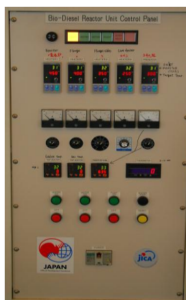
ภาพที่ 3.2 อุปกรณ์ควบคุมอุณหภูมิแบบดิจิตอล (digital controller)
