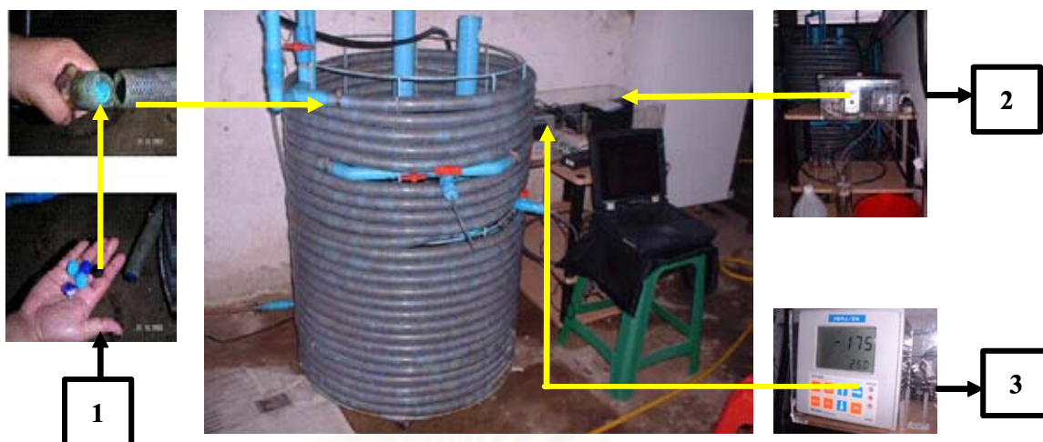
(จ) ลักษณะการติดตั้งอุปกรณ์ต่างๆ ของระบบบำบัดไนเตรต
