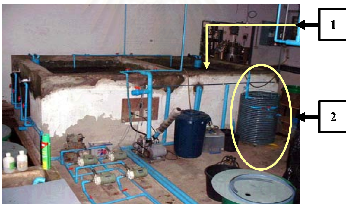
ภาพที่ 3-4 การติดตั้งระบบบำบัดไนเตรทแบบท่อต่อกับถังพักน้ำขนาด 3,743 L (1) ถังพักน้ำขนาด 3,743 L (2) ระบบบำบัดไนเตรทแบบท่อ
