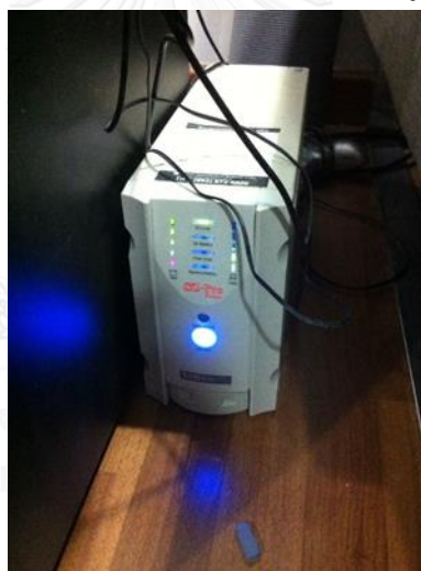
ภาพที่ 3-18 เครื่องสำรองไฟ (UPS)
