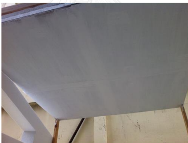
ภาพที่ 3-35 ฝ้าเพดานฉนวนกันความร้อนที่แก้ไขการรั่วซึมของความร้อนระหว่างรอยต่อของแผ่นฝ้า ด้วยแผ่นฝ้าเพดานยิปซัมบอร์ด หนา 9 มิลลิเมตร กรุด้วย EPS foam ความหนาแน่น 1.25 ปอนด์ต่อลูกบาศก์ฟุต ความหนา 2 นิ้ว ติดตั้งด้วยระบบโครงโครงเหล็กชุบสังกะสี ยึดแผ่นฝ้าเพดานกับโครงเหล็กด้วยสกรูดำสำหรับยึดฝ้ายิปซัมบอร์ดขนาด 3 นิ้ว และแก้ไขช่องว่างระหว่างรอยต่อของแผ่นฝ้าเพดานด้วยการติดตั้งลักษณะเข้าลิ้น
