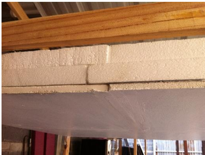
ภาพที่ 3-12 แสดงลักษณะการต่อกันระหว่างแผ่นฝ้าเพดานฉนวนกันความร้อน เป็นลักษณะเข้าลิ้น
