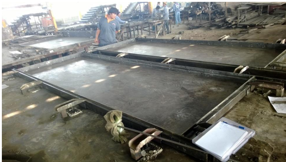
ภาพที่ 4.2 วางแบบเหล็กกันข้างแบบหล่อขึ้นส่วนผนังคอนกรีตสำเร็จรูป
