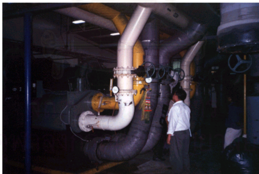
รูปภาพที่ 3.19 การใช้น้ำมาระบายความร้อนให้กับChiller นอกจากจะได้น้ำร้อนจากการระบายแล้วยังช่วยในการประหยัดพลังงานในการระบายความร้อนให้กับChiller อีกทางหนึ่งด้วย
