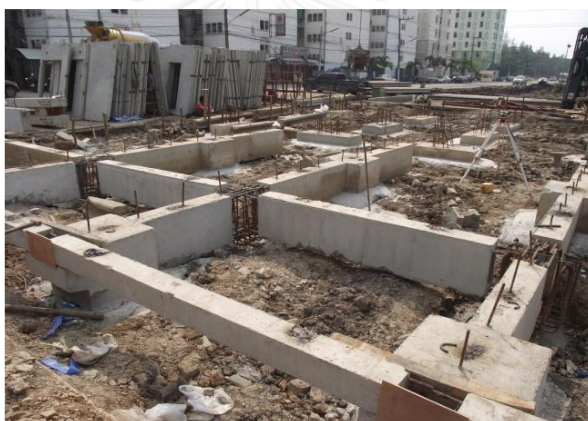
รูปที่ 2.19 การติดตั้งคานคอดิน (สืบตระกูล สมบัติทิพย์, 2554)
