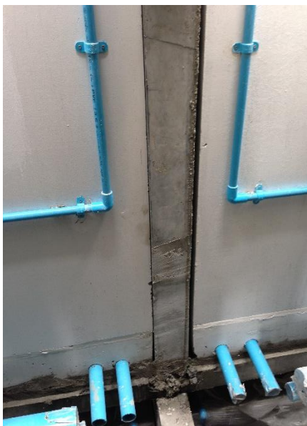
รูปที่ 5.8 การติดตั้งท่อน้ำภายในห้องน้ำสำเร็จรูปเพื่อลดขั้นตอนการทำงานที่หน่วยงานก่อสร้าง
