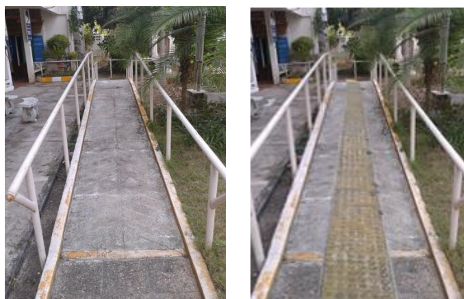
ภาพที่ 92 ขยายขนาดทางเดิน เพิ่ม warning block ป้องกันอันตรายแก่ผู้สูงอายุ
