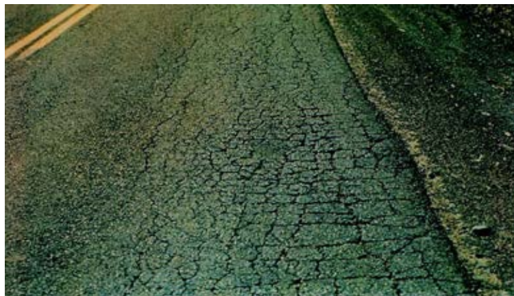
รูปที่ 2.4 การแตกร้าวของแอสฟัลติกคอนกรีตเนื่องจากความล้า (fatigue cracking)
