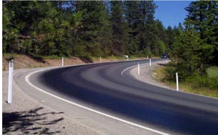
รูปที่ 2.3 การเกิดการเอิ้นน้ำของผิวทางแอสฟัลติกคอนกรีต (bleeding)
