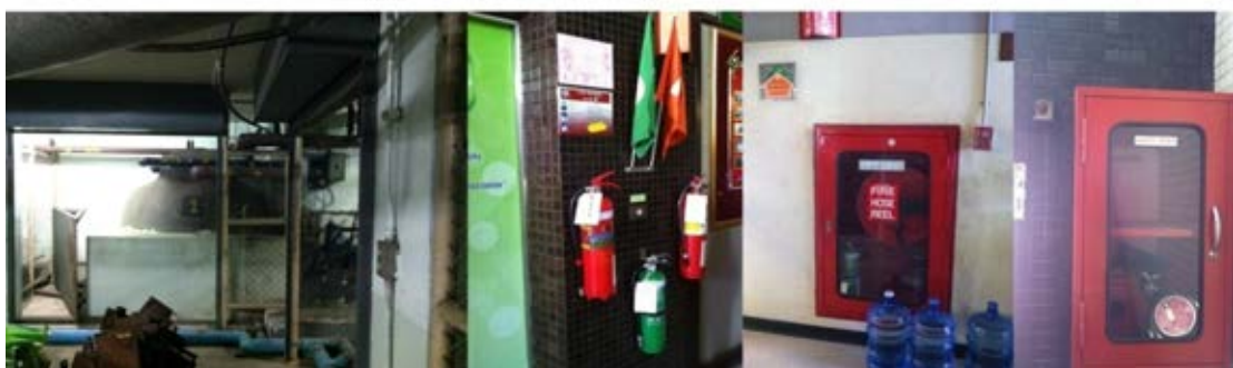
ภาพที่ 4.5 แสดงระบบไฟฟ้าและระบบระบบดับเพลิง กลุ่มอาคารนางเลิ้ง
