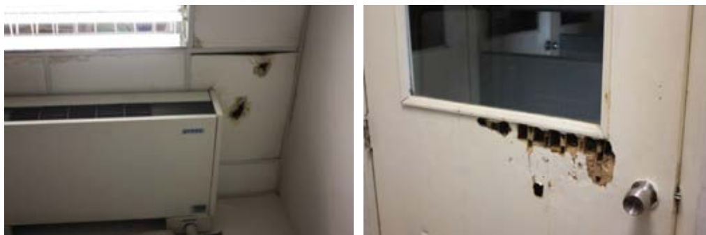
ภาพที่ 5.11 แสดงสภาพทรุดโทรมของฝ้าเพดานและประตูภายในอาคาร
