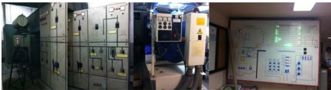
ห้องเครื่องไฟฟ้าและเครื่องกำเนิดไฟฟ้า
