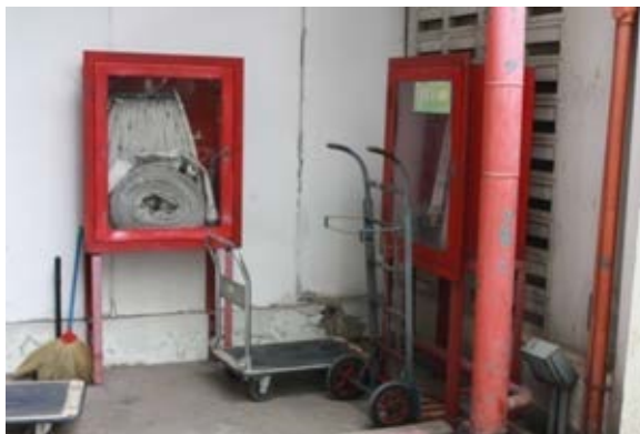
ภาพที่ 5.14 แสดงสภาพการวางอุปกรณ์ขวางบริเวณหน้าตู้ดับเพลิงของอาคาร
