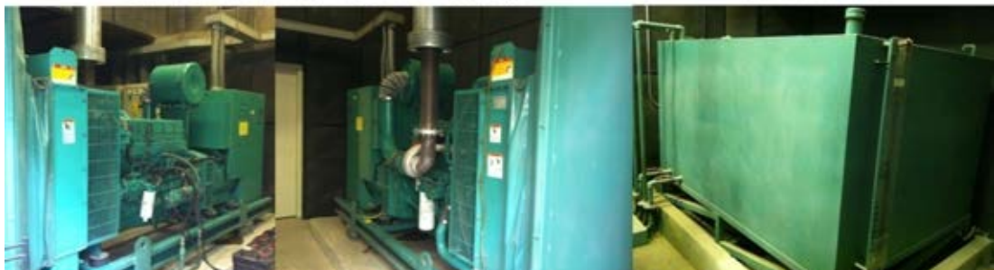
ภาพที่ 4.12 แสดงระบบไฟฟ้ากำลังและเครื่องกำเนิดไฟฟ้า กลุ่มอาคารประชาชน
