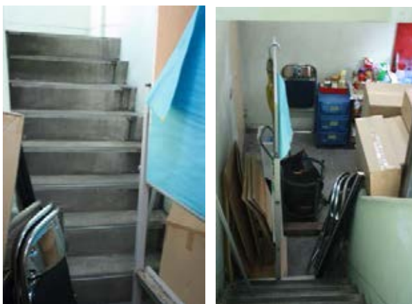
ภาพที่ 5.7 แสดงสภาพการวางวัสดุอุปกรณ์ขวางบริเวณหน้าบันไดหนีไฟอาคารสำนักงาน 3 ชั้น
