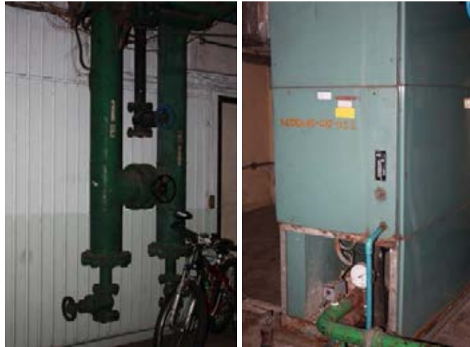
ภาพที่ 5.4 แสดงสภาพทรุดโทรมของระบบประกอบอาคาร
