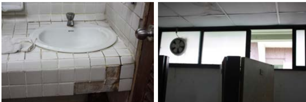
ภาพที่ 5.3 แสดงสภาพทราดโทรมของห้องน้ำภายในอาคารสำนักงาน 3 ชั้น
