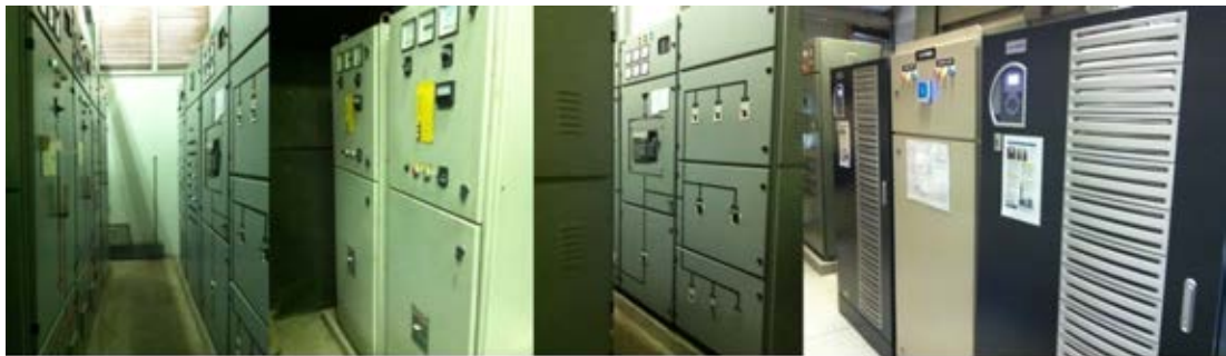
ห้องเครื่องไฟฟ้า หม้อแปลงไฟฟ้าขนาด 500 KVA จำนวน 1 ชุด
