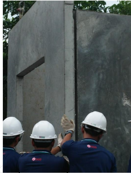
(ข) ขั้นตอนการติดตั้งแผ่นคอนกรีตหล่อสำเร็จ
