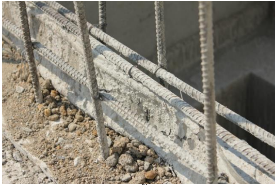
(ก) หลังจากเทคอนกรีตชั้นแรกแล้ว จำเป็นต้อง ทำความสะอาดแผ่นยาง PVC ก่อนการเท คอนกรีตชั้นถัดไป
