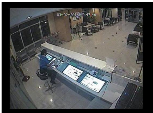
ภาพที่ 44 ภาพแสดงภาพจากระบบโทรทัศน์วงจรปิดภายในโครงการฯ ตารางที่ 62 แสดงรายการค่าใช้จ่ายระบบโทรทัศน์วงจรปิด (CCTV)
