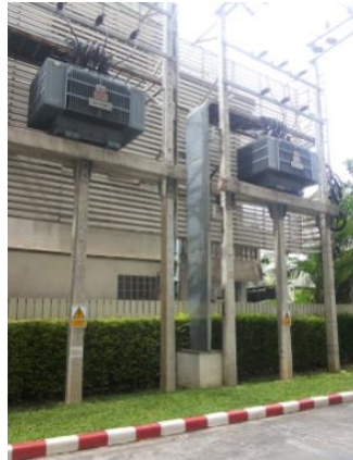
ภาพที่ 15 แสดงหม้อแปลงไฟฟ้าโครงการ
