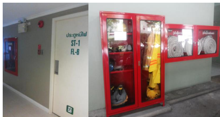
ภาพที่ 17 แสดงอุปกรณ์ดับเพลิง
