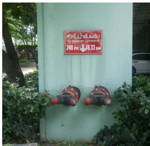
ภาพที่ 39 ภาพแสดงหัวรับน้ำดับเพลิง
