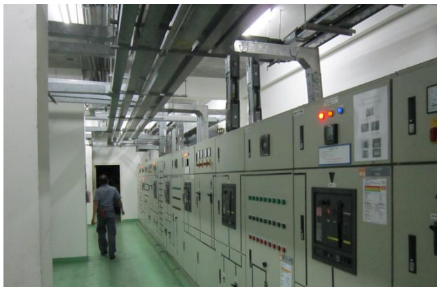
ภาพที่ 13 แสดงห้องเครื่องไฟฟ้า
