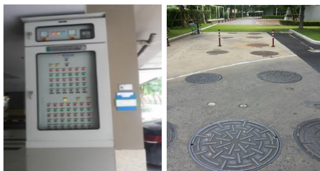
ภาพที่ 11 แสดงแผงควบคุมระบบบำบัดน้ำเสีย
