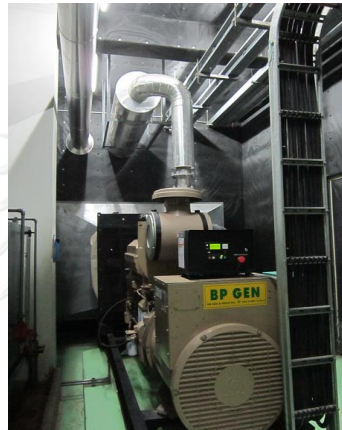
ภาพที่ 16 แสดงเครื่องกำเนิดไฟฟ้าสำรอง
