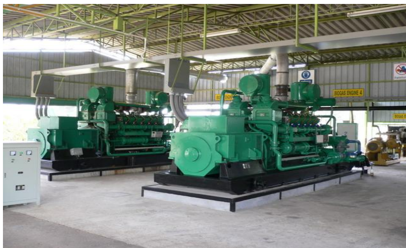
รูปที่ 4.12 เครื่องกำเนิดไฟฟ้าขนาด 500 kW แบบติดตั้งคู่ (Model: 500GF1-RZ 2 SETS)
