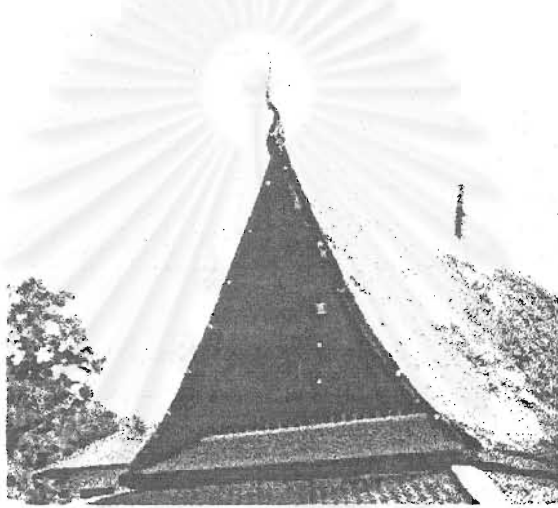
ภาพที่ 5.47 ส่วนไม้ปั้นลม ที่ทำจากไฟเบอร์กลาสที่ ลิมวัดกลางโคกต่อ ที่มาของภาพ: ลิขารณ์ วิหันทวงศ์, พฤศจิกายน พ.ศ.๒๕๒๖
