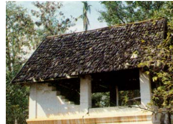
ภาพที่ 4.28 สิมวัดโพธิ์พิพัฒน์ราม บ้านสูงเนิน อ.คำม่วง จ.กาฬสินธุ์ หลังคาแป้นเกล็ดไม้ วัสดุดั้งเดิมซึ่งเจ้าอาวาสได้เข้าใจถึงคุณค่างานสถาปัตยกรรมพื้นถิ่นจึงได้ทำการอนุรักษ์ไว้
