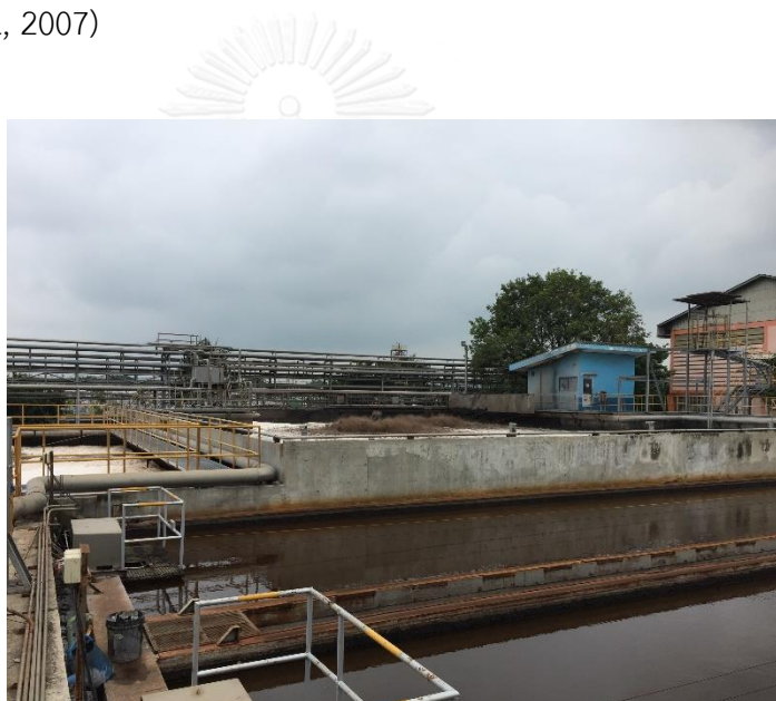
รูปที่ 4.26 บ่อเติมอากาศและบ่อตกตะกอนชั้นที่ 1 ของระบบบำบัดน้ำเสียโรงงานผลิตกระดาษ
