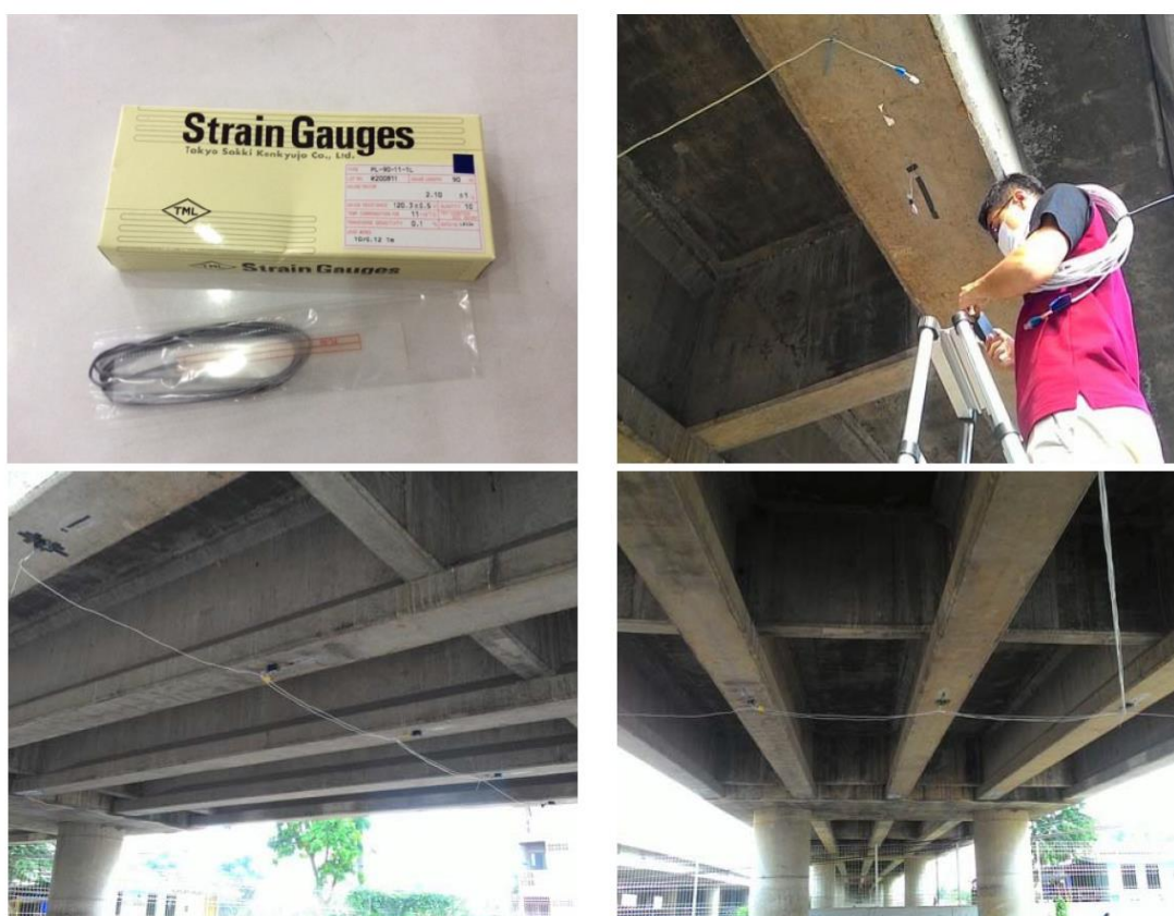
รูปที่ 3.7 มาตรวัดน้ำหนักและการติดตั้ง
