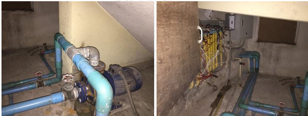
รูปที่ 42 งานระบบน้ำพุ
