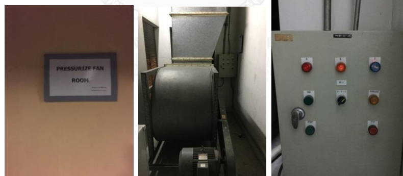
รูปที่ 34 งานระบบปรับอากาศ (Pressurize Fan)
