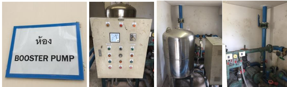
รูปที่ 37 งานระบบสุขาภิบาล (Booster pump)
