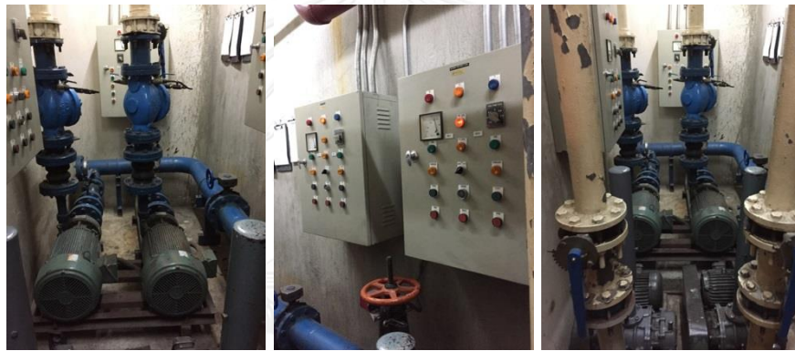
รูปที่ 36 งานระบบสุขาภิบาล (ปั๊มน้ำ)
