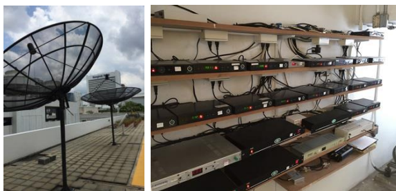
รูปที่ 29 งานระบบสื่อสาร (ระบบโทรทัศน์)
