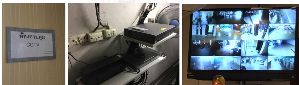
รูปที่ 30 งานระบบสื่อสาร (ระบบโทรทัศน์วงจรปิด)
