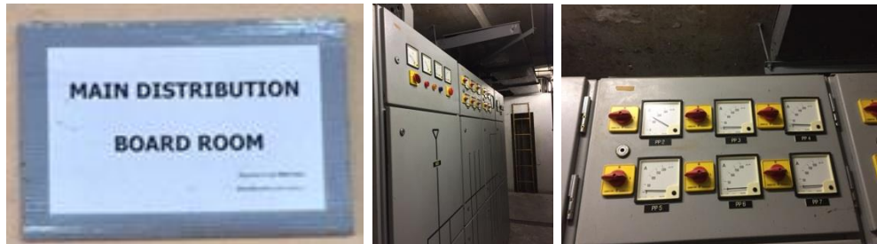
รูปที่ 31 งานระบบไฟฟ้ากำลัง
