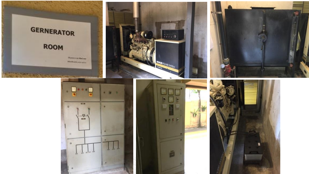
รูปที่ 33 งานระบบไฟฟ้าฉุกเฉิน
