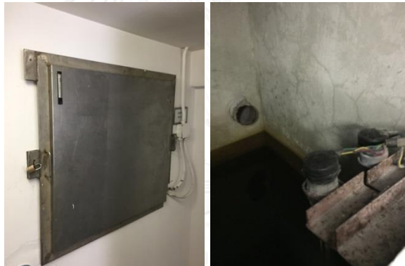
รูปที่ 38 งานระบบสุขาภิบาล (Roof Tank)
