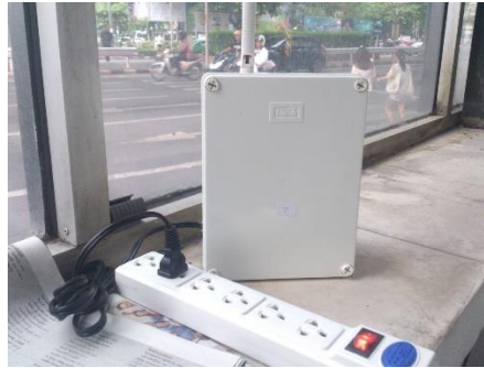
ก) การวางอุปกรณ์ภายในป้อมตำรวจ
